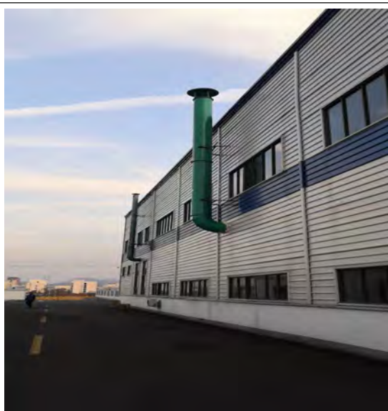
抛丸除尘排气筒
