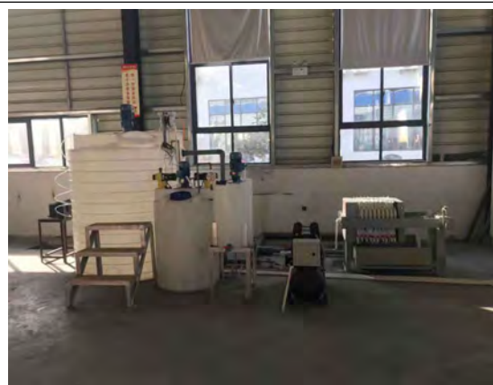
污水处理设施
