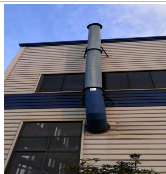
打磨除尘排气筒
